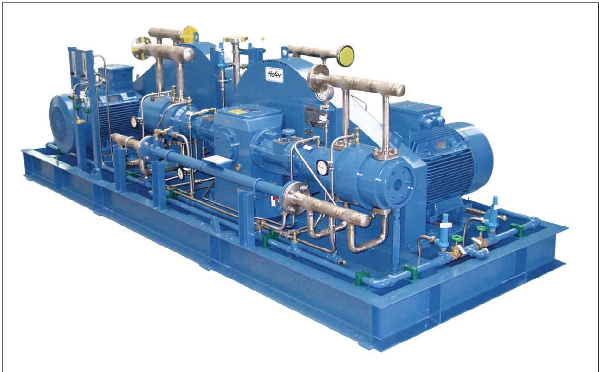
▲ 如上图所示为安装在某天然气冲装站 HOFER 压缩机
